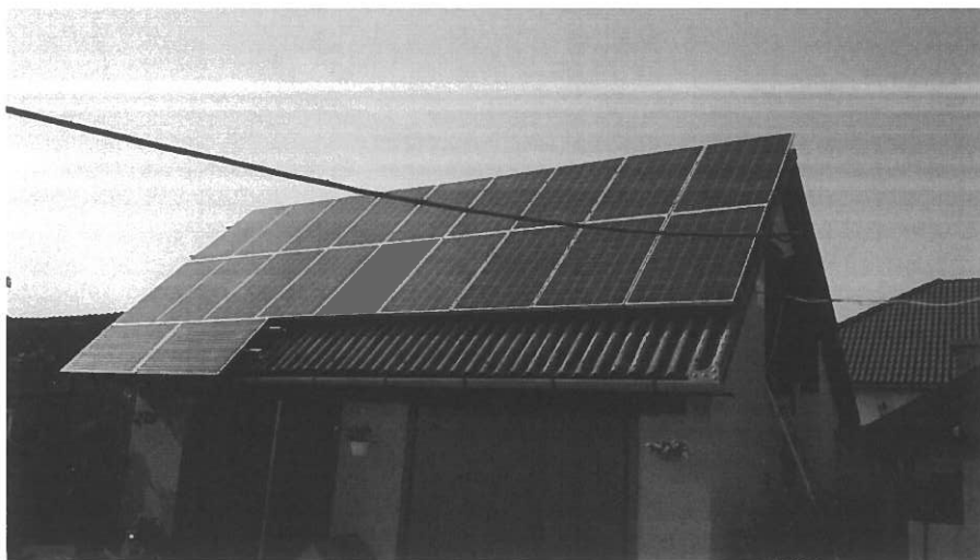
5 kW-os napelemes rendszer Vásárosnaményban. Forrás: szabolcs-solar.hu
